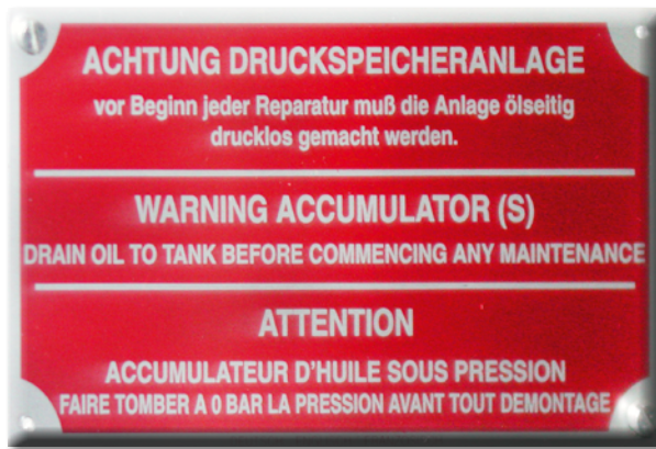
Abb. 21 Warnhinweis an Druckspeicheranlage
