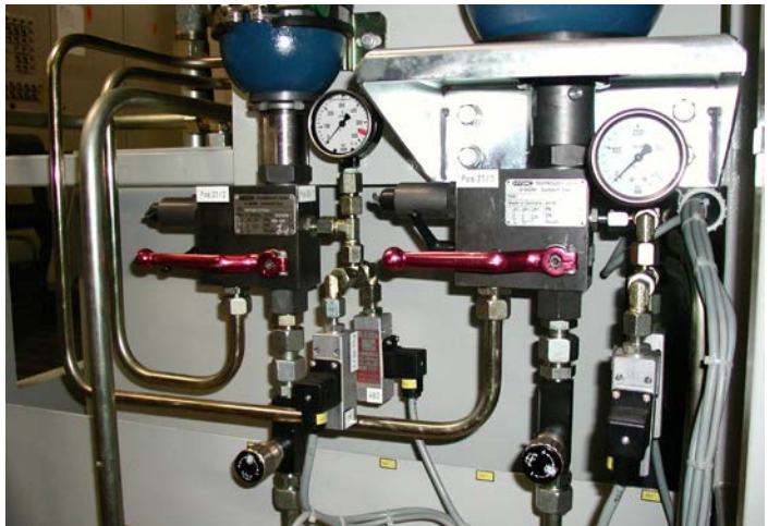
Abb. 25 Druckentlastete Hydrospeicher mit abgesperrten Druckleitungen
