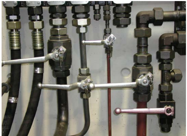
Abb. 3 Sichern gegen Wiedereinschalten durch abschließbare Kugelhähne
